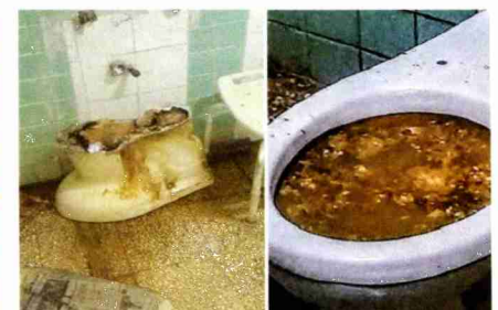
Las deplorables condiciones del hospital Celia Sánchez Manduley de Manzanillo
